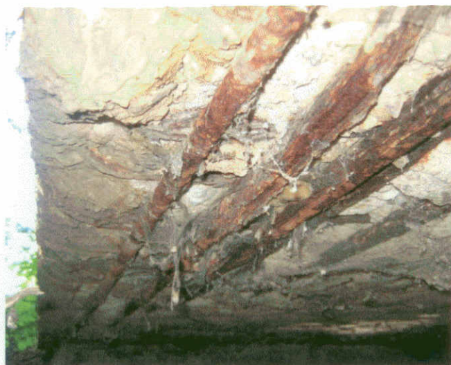
Poškozená strana nosné konstrukce- korozi silně poškozená výztuž.
