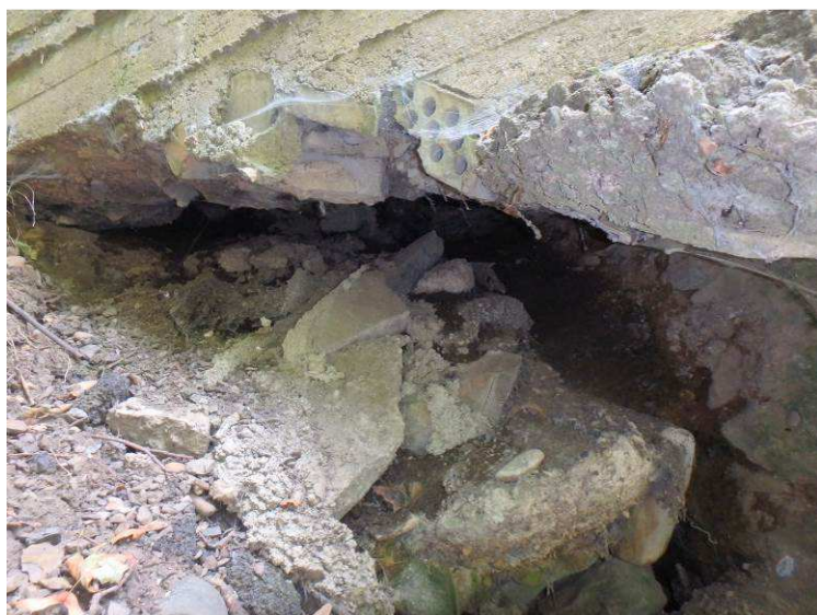
Obr. 2.11 – hluboká kaverna (až 1 m) v levé části opěry OP2
