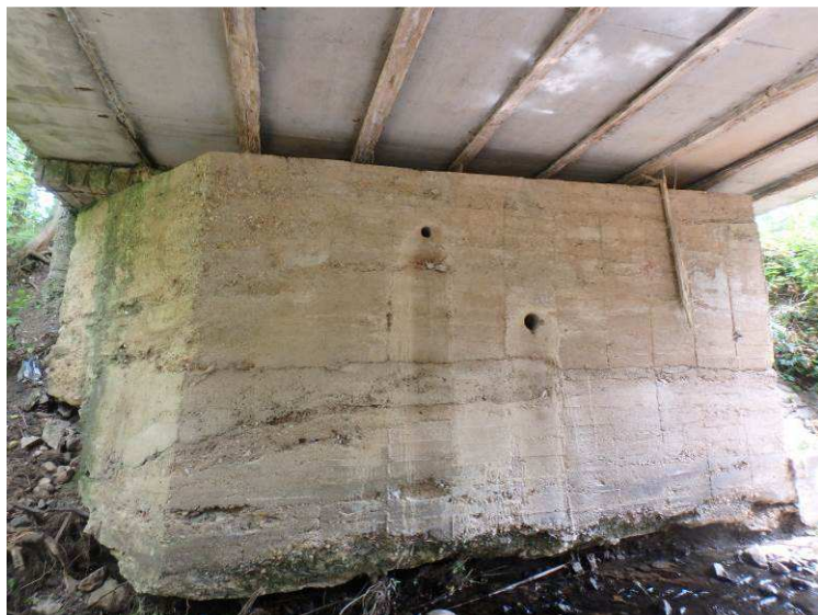
Obr. 2.7 – pohled na opěru OP2, v dolní části dřívku opěry viditelné hloubkové podemletí opěry (cca 0,5 m)
