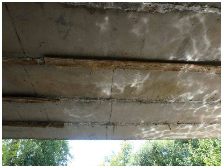
Obr. 2.16 – dolní líc nosné konstrukce, ponechané bednění spár mezi nosníky, stopy po silném zatékání spárami mezi nosníky
