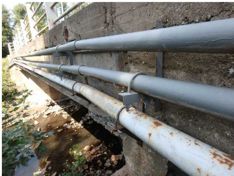
Obr. 2.25 – převáděné chráničky na pravé straně mostu, začínající koroze chrániček i úchytů
