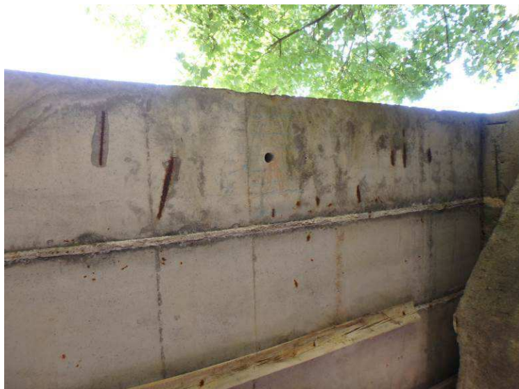
Obr. 2.19 – dolní líc krajního nosníku, stopy po zatékání po vnějším líci, vlivem nedostatečné tloušťky krycí výztuže dochází ke korozi příčné betonářské výztuže
