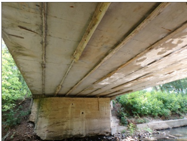
Pohled na opěru OP2, v dolní části dřívku opěry viditelné hloubkové podemletí opěry (cca 0,5 m)
