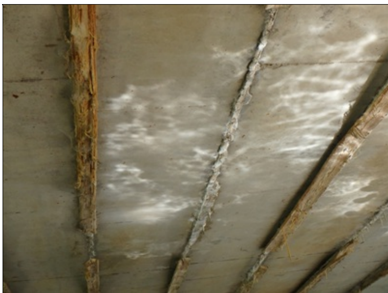
Dolní líc nosné konstrukce, ponechané bednění spár mezi nosníky, stopy po silném zatékání spárami mezi nosníky
