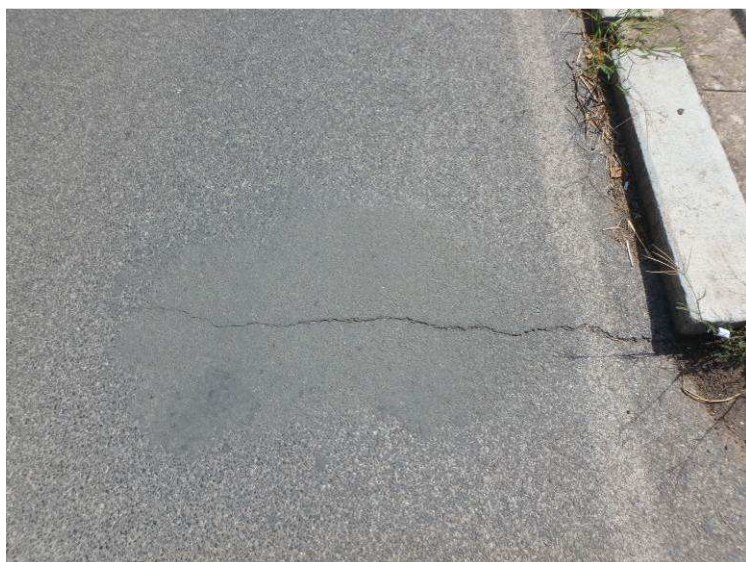
Obr. 2.20 – příčná trhлина ve vozovce nad opěrou OP1
