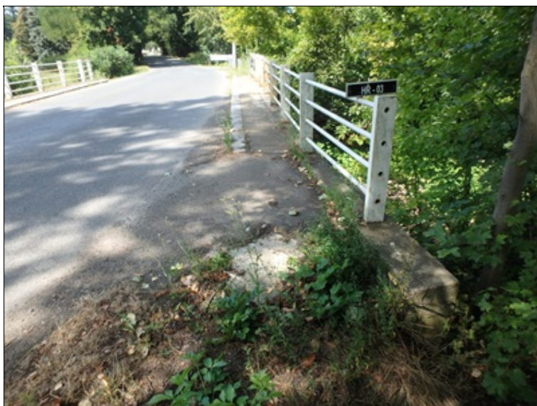
Levá strana opěry OP2, vozovka je rozšířená směrem k chodníku, kraje vozovky jsou propadlé, uchycená vegetace
