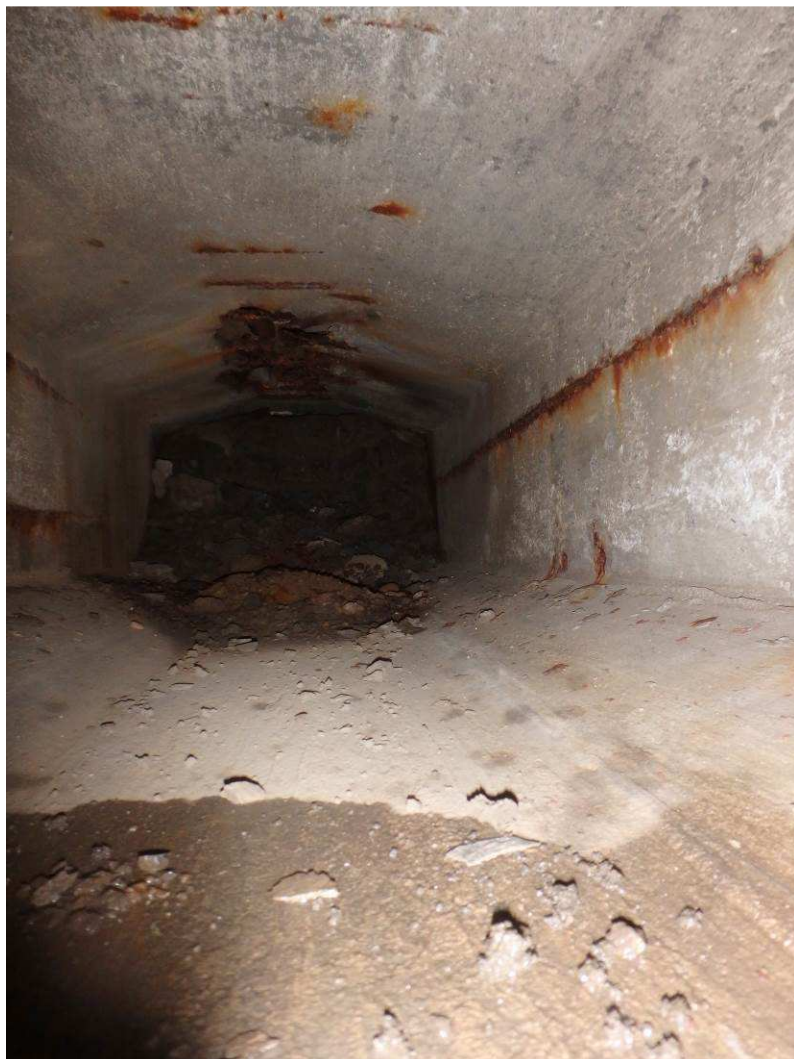
Obr. 3.32 – D2 – dutina nosníku N8, u opěry OP1
