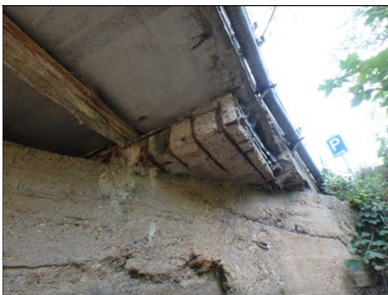
Vykonzolidování pravé části úložného prahu opěry OP2, silná koroze betonářské výztuže úložného prahu
