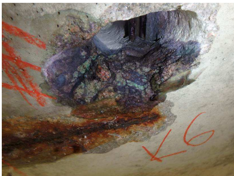
Obr. 3.16 – typický průběh karbonatace, zkušební místo K6 - v hloubce 0-15 mm je pH = 9 - v hloubce > 15 mm je pH > 11-13
