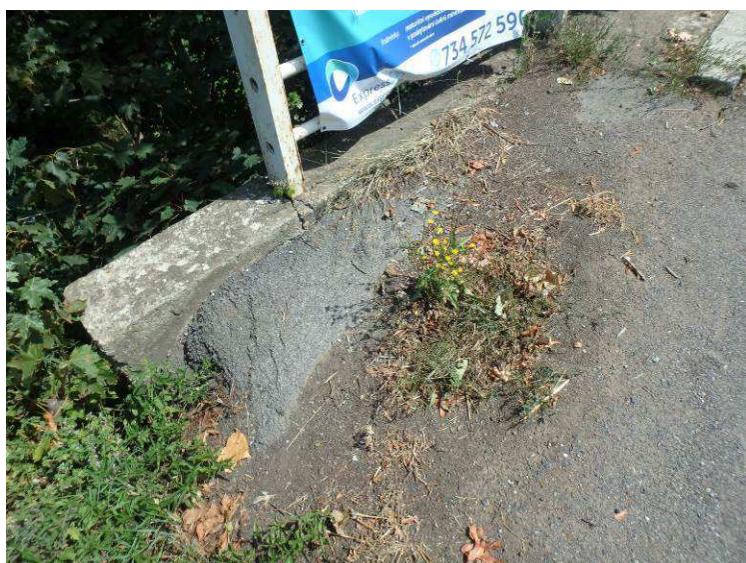
Obr. 2.21 – napojení chodníku na levé straně opěry OP1, napojení je propadlé, uchycená vegetace
