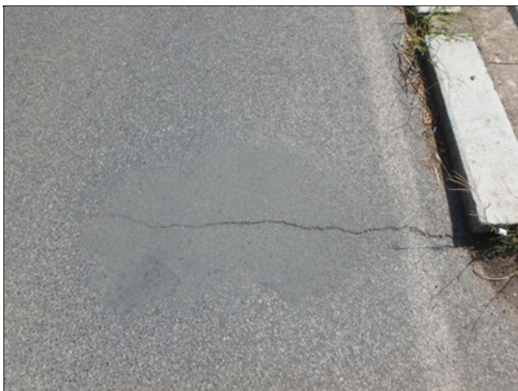
Příčná trhлина ve vozovce nad opěrou OP1
