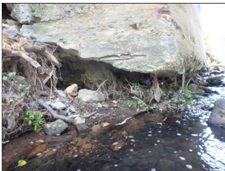
Hloubkové podemletí (až 1 m) levého rohu opěry OP2
