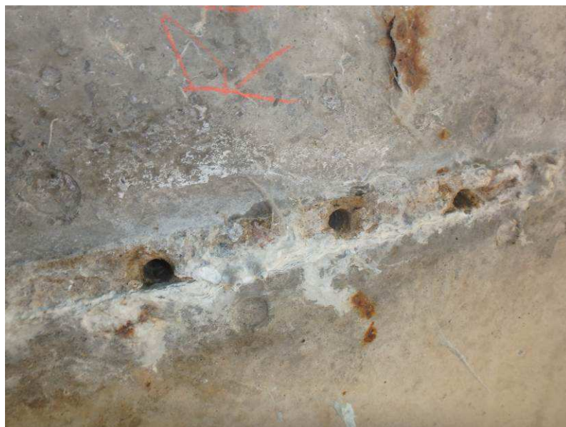
Obr. 3.11 – RCT10 – nosná konstrukce, spára mezi nosníky N1 a N2, dolní líc, silné výluhy pojiva
