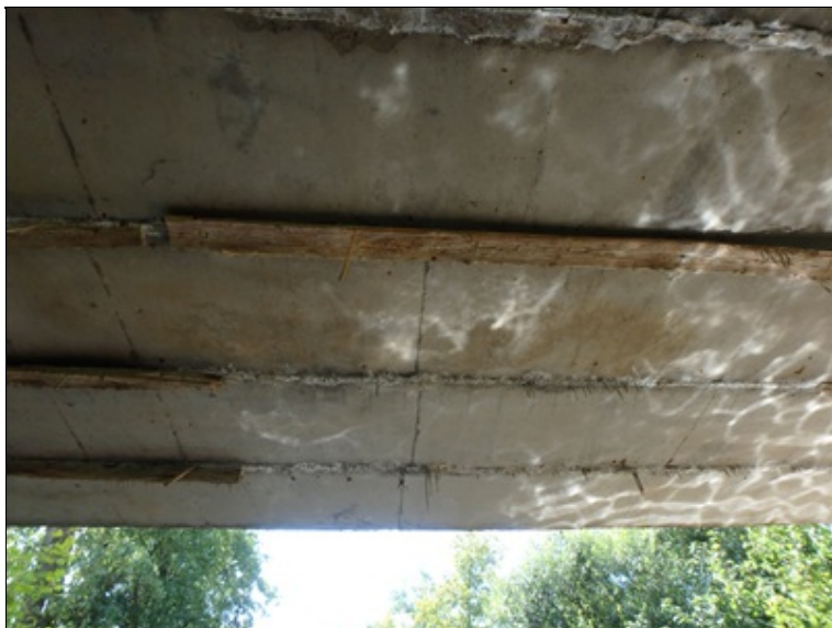
Dolní líc nosné konstrukce, ponechané bednění spár mezi nosníky, stopy po silném zatékání spárami mezi nosníky
