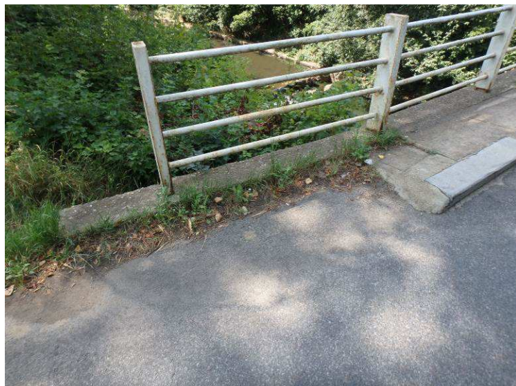
Obr. 2.22 – napojení chodníku na pravé straně opěry OP2, uchycená vegetace
