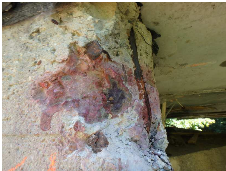
Obr. 3.13 – typický průběh karbonatace, zkušební místo K1
