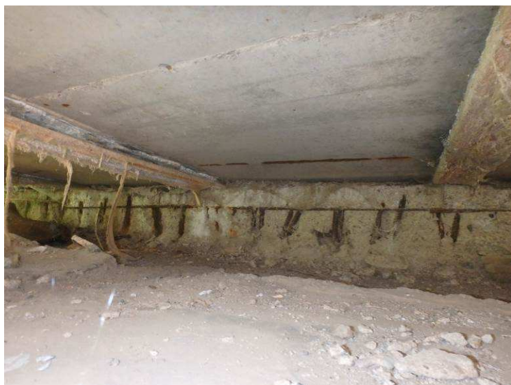
Obr. 2.15 – úložný práh opěry OP2, stopy po silném zatékání, silná koroze betonářské výztuže
