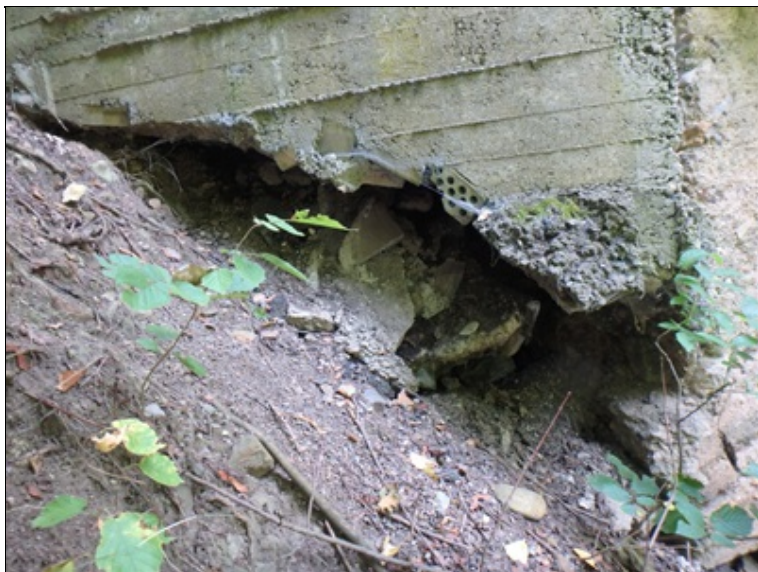
Hluboká kaverna (až 1 m) v levé části opěry OP2
