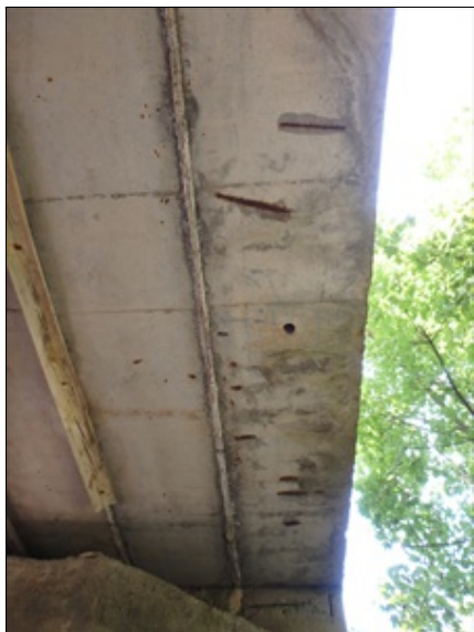
Dolní líc krajního nosníku, stopy po zatékání po vnějším líci, vlivem nedostatečné tloušťky krycí výztuže dochází ke korozi příčné betonářské výztuže
