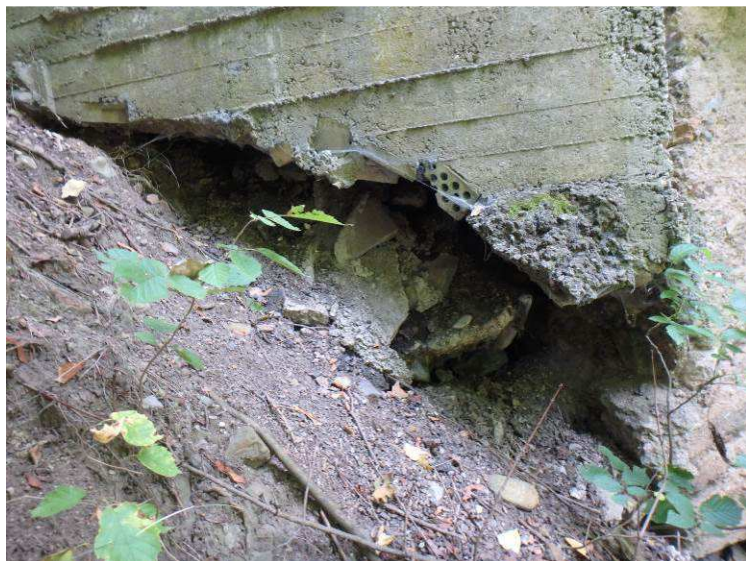
Obr. 2.10 – hluboká kaverna (až 1 m) v levé části opěry OP2
