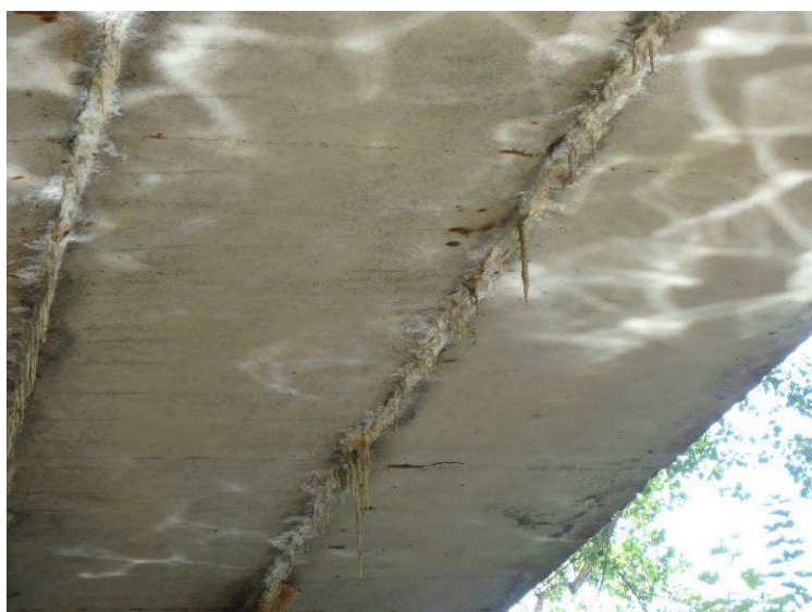
Obr. 2.18 – dolní líc nosné konstrukce, stopy po silném zatékání spárami mezi nosníky, výluhy pojiva v podobě krápníků
