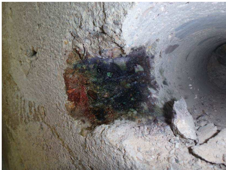
Obr. 3.14 – typický průběh karbonatace, zkušební místo K2 - v hloubce 0-26 mm je pH = 9 - v hloubce > 26 mm je pH > 11-13
