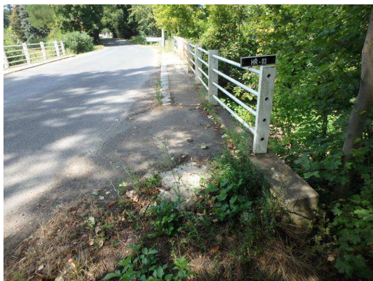
Obr. 2.23 – levá strana opěry OP2, vozovka je rozšířená směrem k chodníku, kraje vozovky jsou propadlé, uchycená vegetace
