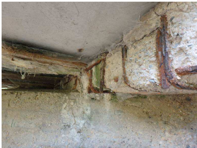
Obr. 2.13 – vykonzolování pravé části úložného prahu opěry OP2, silná koroze betonářské výztuže úložného prahu
