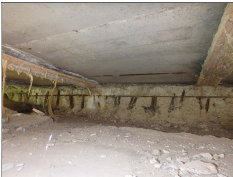
Úložný práh opěry OP2, stopy po silném zatékání, silná koroze betonářské výztuže
