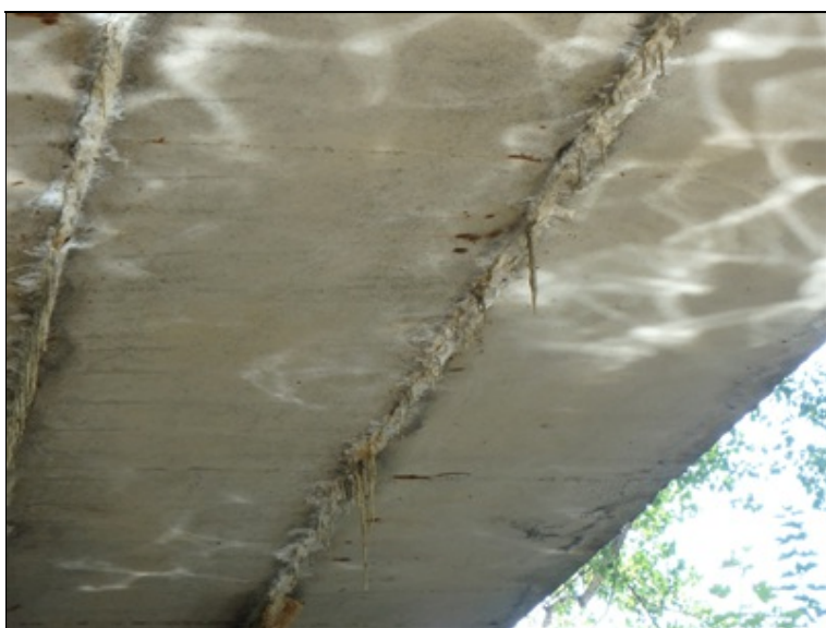
Dolní líc nosné konstrukce, stopy po silném zatékání spárami mezi nosníky, výluhy pojiva v podobě krápníků
