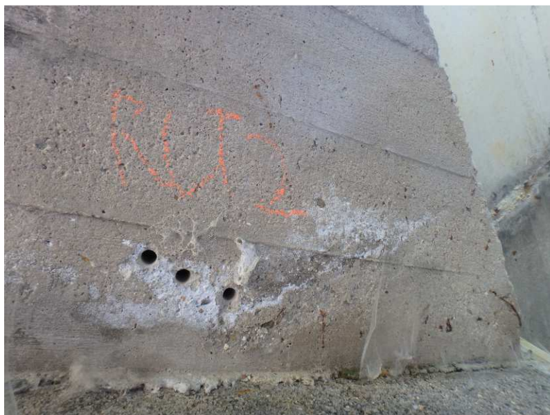
Obr. 3.8 – RCT2 – spodní stavba, opěra OP1, úložný práh, pravá strana, dolní líc, v místě výluhů pojiva
