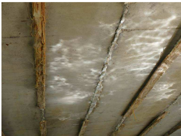
Obr. 2.17 – dolní líc nosné konstrukce, ponechané bednění spár mezi nosníky, stopy po silném zatékání spárami mezi nosníky
