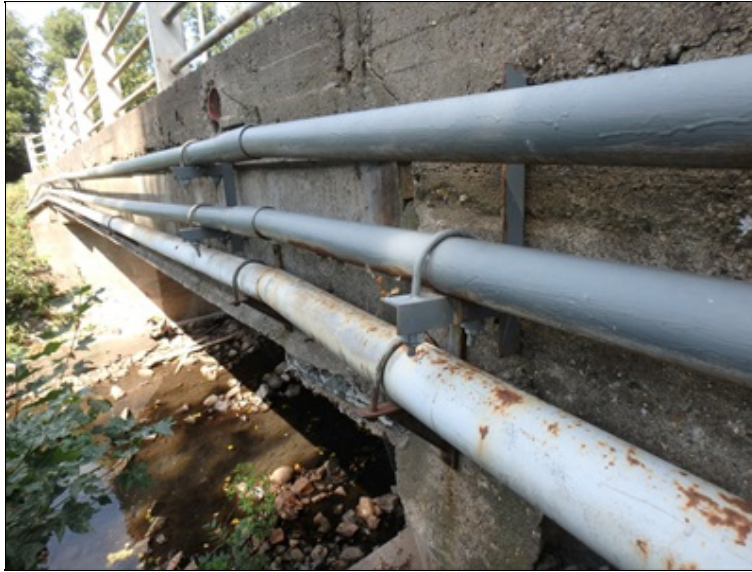
Převáděné chráničky na pravé straně mostu, začínající koroze chrániček i úchytů
