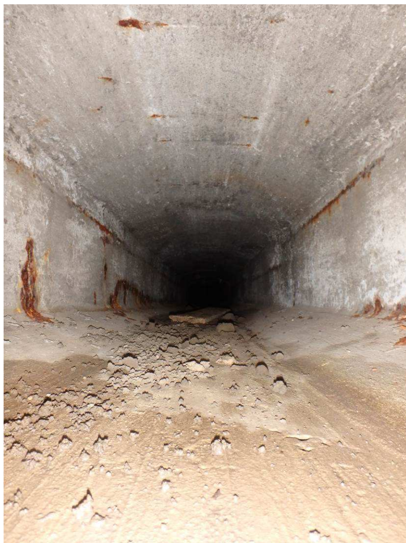
Obr. 3.33 – D2 – dutina nosníku N8, u opěry OP1
