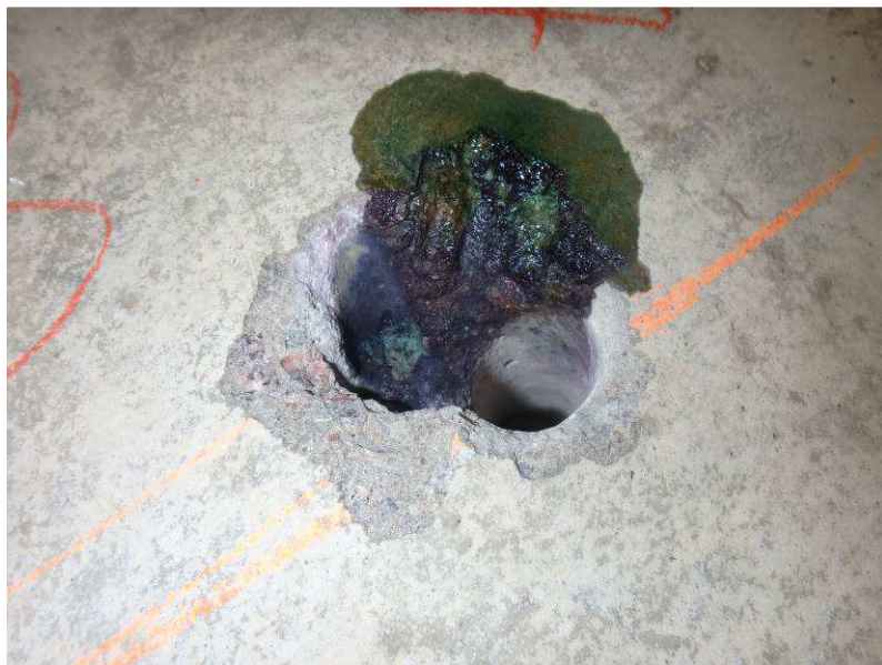
Obr. 3.17 – typický průběh karbonatace, zkušební místo K7 - v hloubce 0-5 mm je pH = 9 - v hloubce > 5 mm je pH > 11-13
