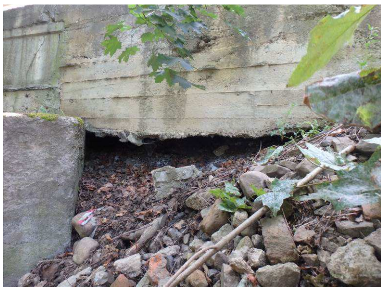
Obr. 2.8 – hluboká kaverna (více než 1 m) v přechodové části levé strany opěry OP1
