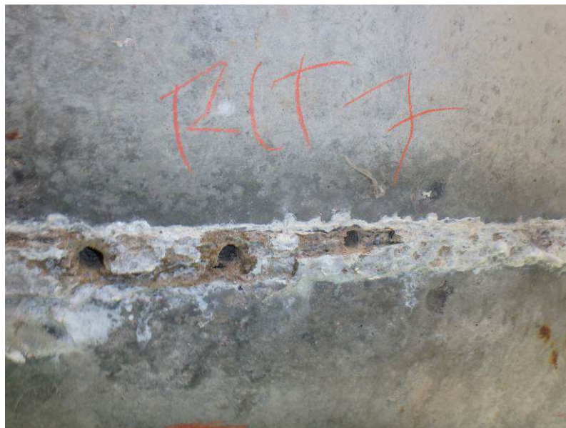
Obr. 3.10 – RCT7 – nosná konstrukce, spára mezi nosníky N1 a N2, dolní líc, silné výluhy pojiva
