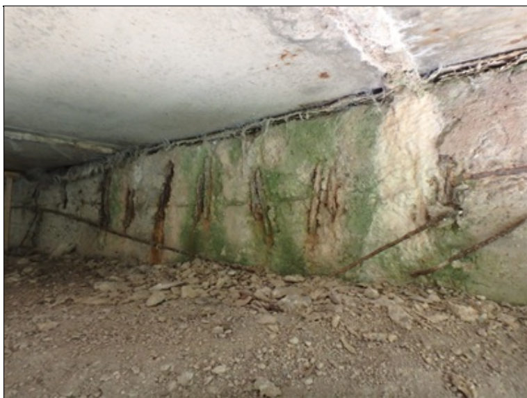
Úložný práh opěry OP1, stopy po silném zatékání, biocidní napadení betonu, silná koroze betonářské výztuže
