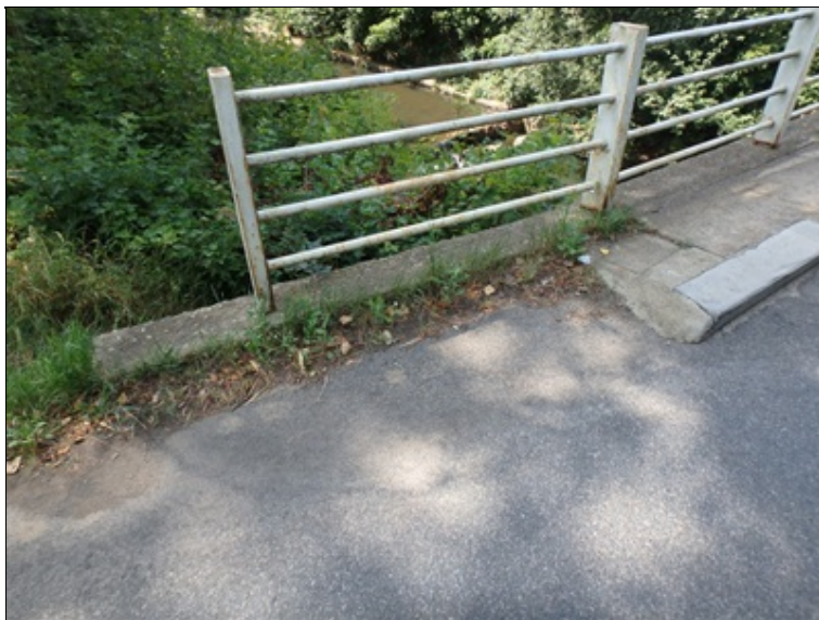
Napojení chodníku na pravé straně opěry OP2, uchycená vegetace
