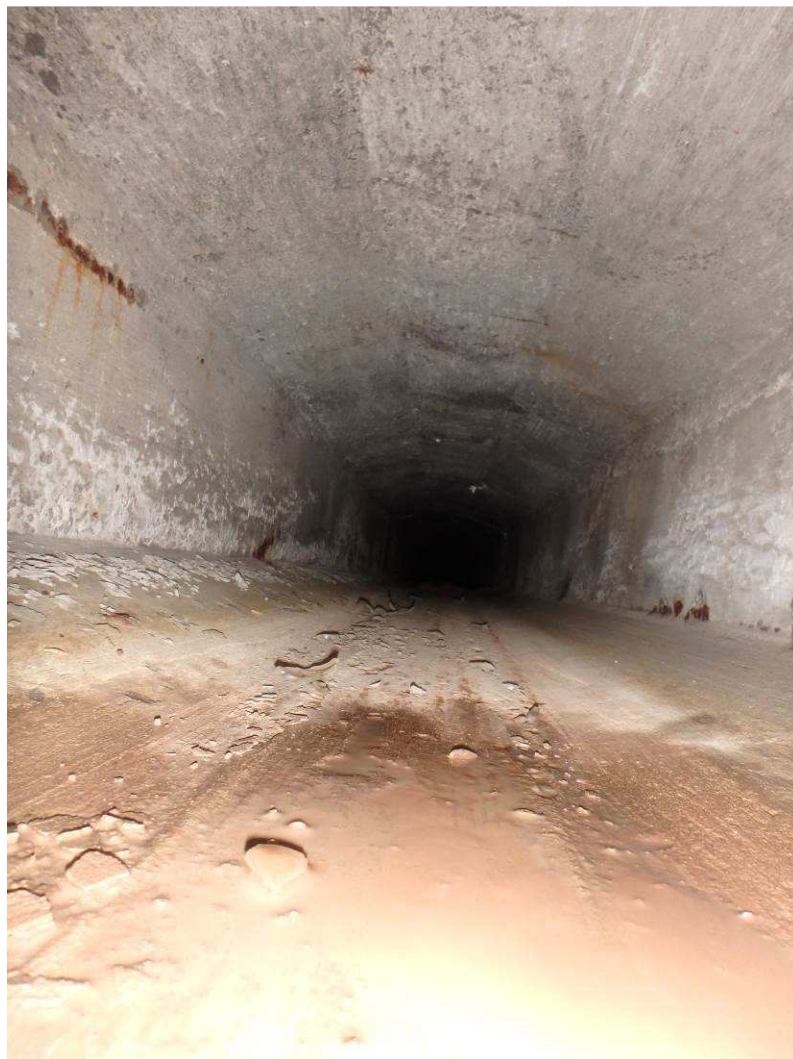
Obr. 3.31 – D1 – dutina nosníku N1, u opěry OP1, pohled ve směru staničení
