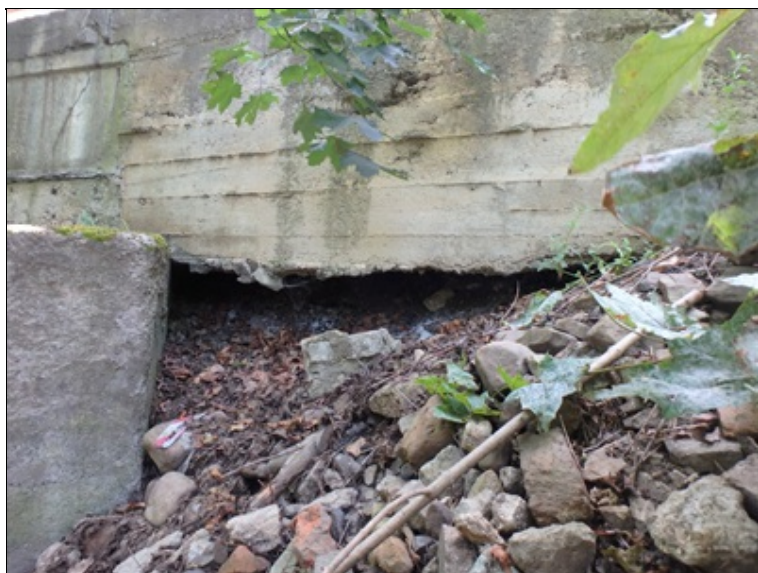
Hluboká kaverna (více než 1 m) v přechodové části levé strany opěry OP1
