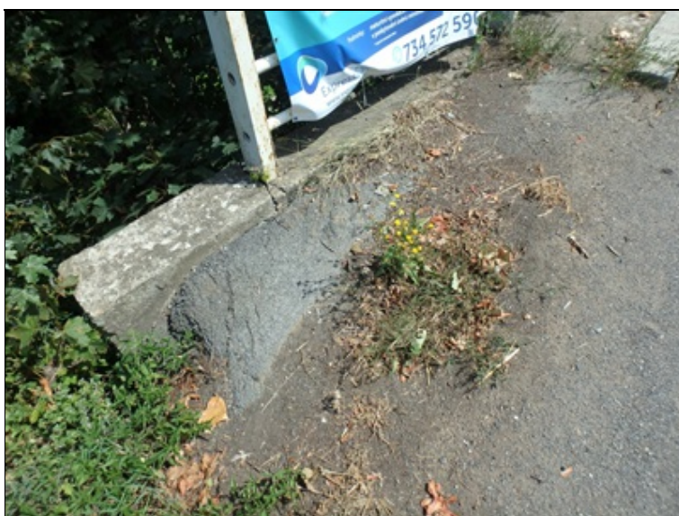
Napojení chodníku na levé straně opěry OP1, napojení je propadlé, uchycená vegetace
