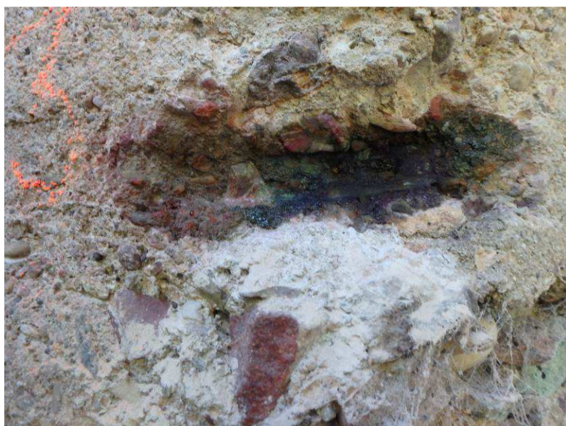
Obr. 3.15 – typický průběh karbonatace, zkušební místo K5 - v hloubce 0-40 mm je pH = 9 - v hloubce > 40 mm je pH > 11-13
