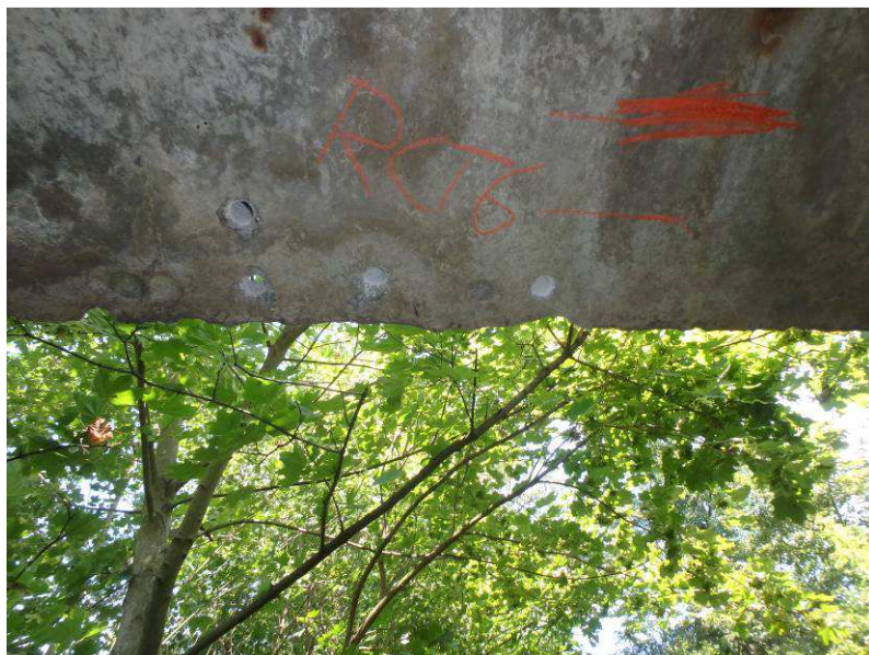
Obr. 3.9 – RCT6 – nosná konstrukce, nosník N1, dolní líc, levá hrana, stopy po stékání vody po líci nosníku, stojatá voda uvnitř dutiny nosníku
