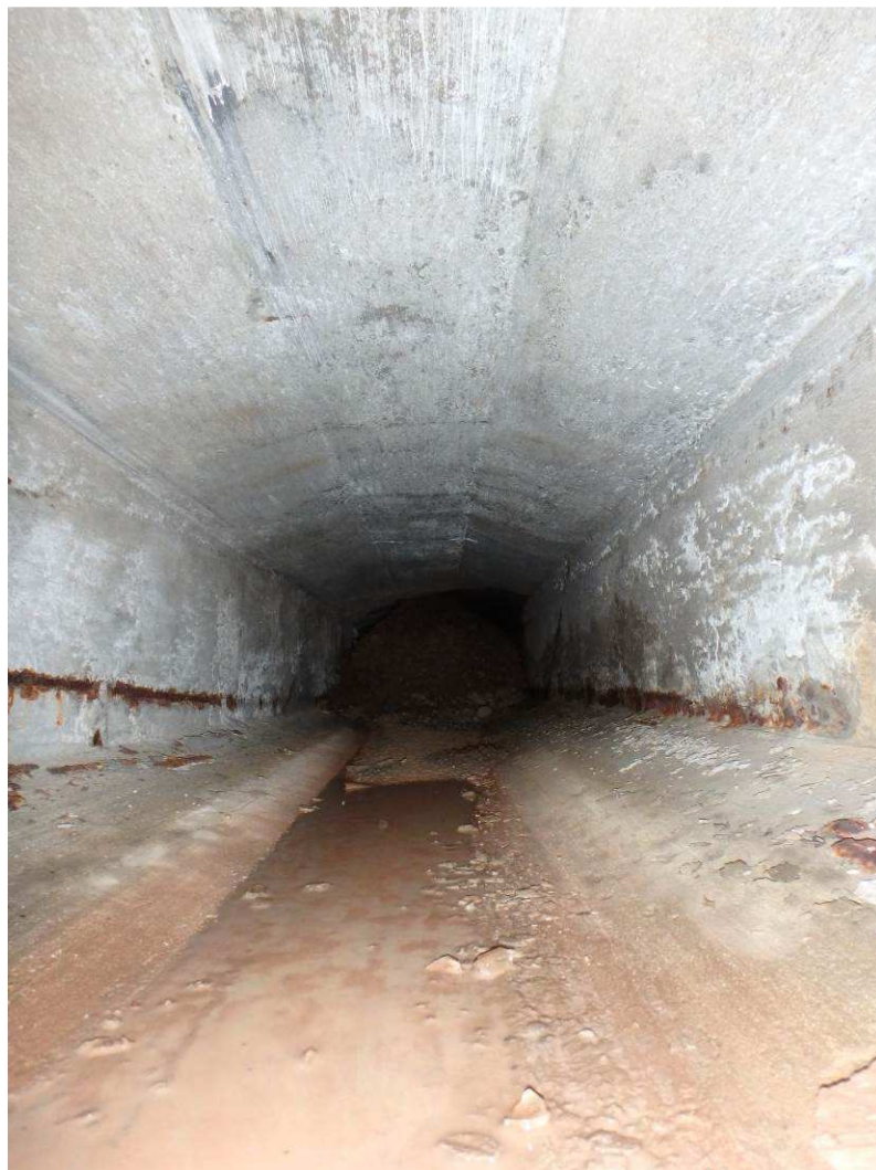
Obr. 3.30 – D1 – dutina nosníku N1, u opěry OP1, pohled na opěru OP1
