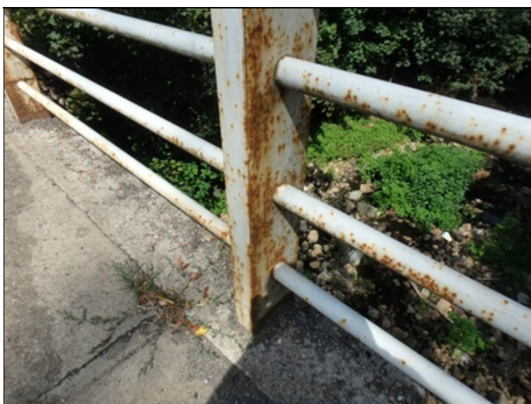
Nefunkční PKO zábradlí, plošná koroze záchytného systému
