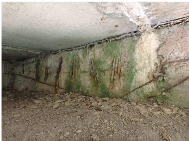
Obr. 2.14 – úložný práh opěry OP1, stopy po silném zatékání, biocidní napadení betonu, silná koroze betonářské výztuže
