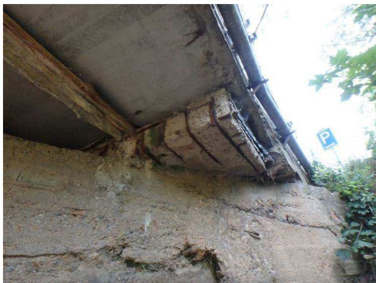
Obr. 2.12 – vykonzolování pravé části úložného prahu opěry OP2, silná koroze betonářské výztuže úložného prahu
