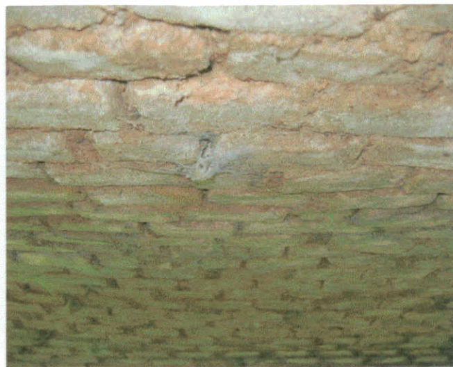
Vlasové trhliny procházející klenbou.
