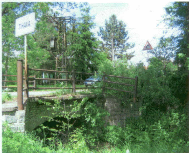
Protiproudňí strana, utržené zábradlí
