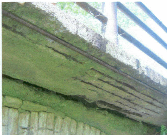
Poškozená konstrukce římky (protiproudňí strana).
