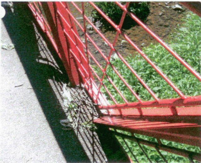
Pohled na dolní pásnici-silné znečištění.
