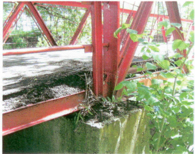
Detail horní -znečištěné části podpěry.
